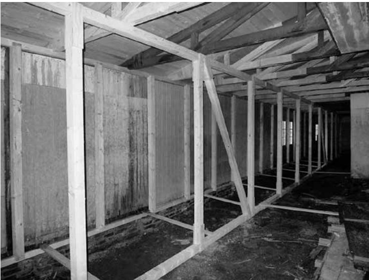
Abb. 3a/3b: Blick in die Baracke z4 vor Beginn und nach dem Abschluss der Sicherungs- und Sanierungsmaßnahmen. Man erkennt das statisch notwendige zusätzliche Ständerwerk, eine Rahmenkonstruktion, um die nicht mehr standfähigen Wandelemente »hängend« in ihrer Position zu halten, die ausgebesserten Dachbinder und -verschalungen sowie die Fehlstellen, wo die abgängigen, nicht notwendigen Bodendielen und Deckenverkleidungen nicht ersetzt wurden. Fotos: Andreas Ehresmann, 18. 4. 2007 (links) und 22. 12. 2008 (rechts).
